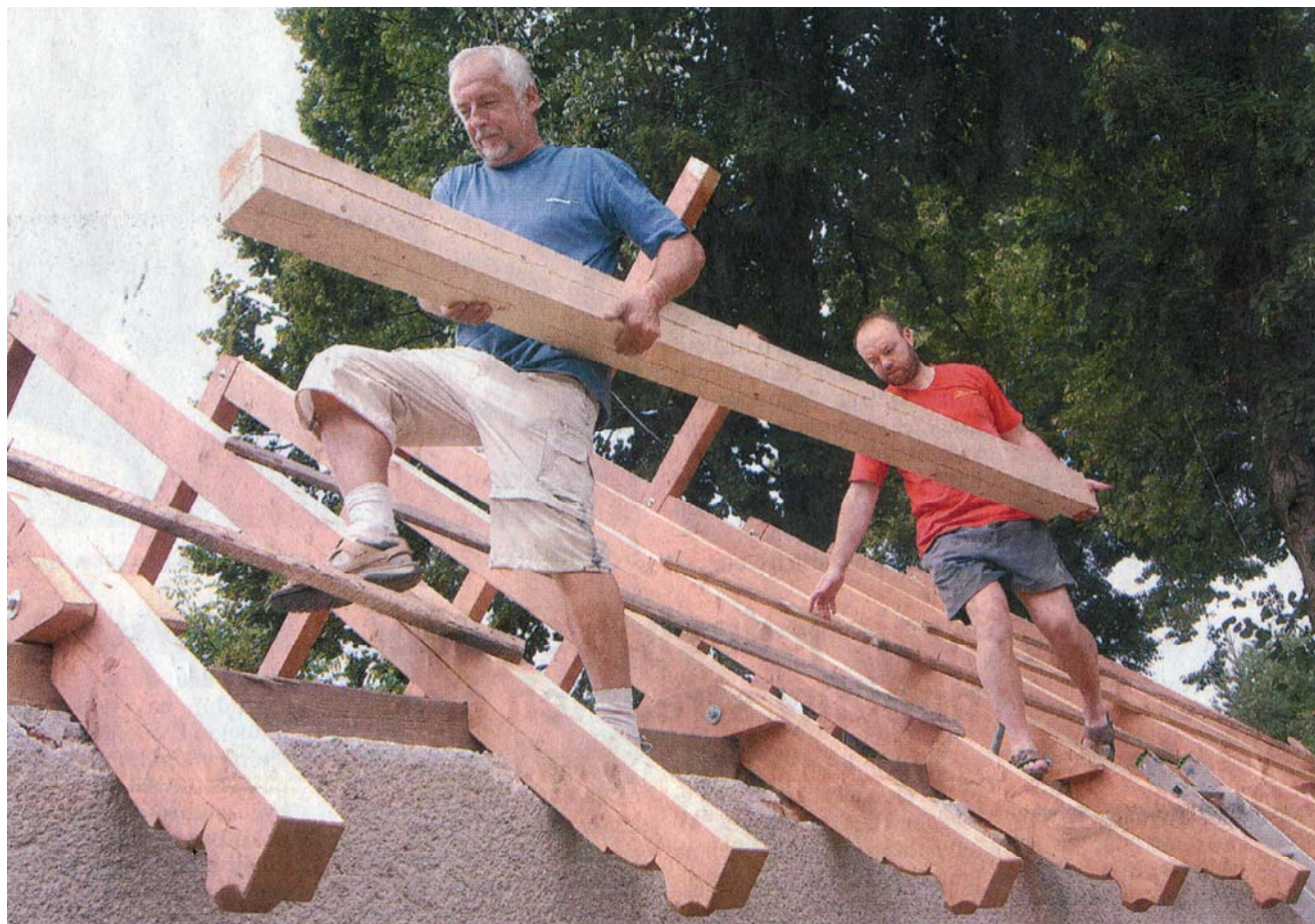
Střecha. Miroslav Klínger a Petr Dytrch dávají starobylé hasičské zbrojnici nové krovy.
